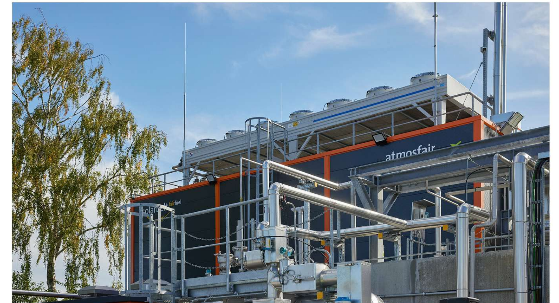
Anlage zur Produktion von PtL-Rohöl in Werlte
